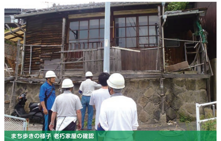
まち歩きの様子 転落危険箇所の確認
