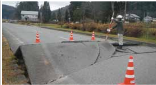
道路被害の状況
