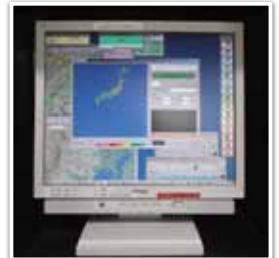
防災センター内の緊急地震速報と雷・気象情報のモニター
