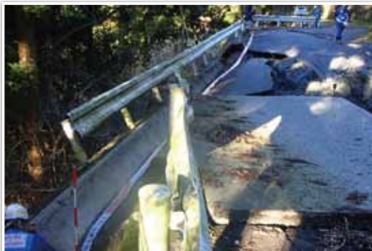
道路の被災状況調査（H26長野県北部地震）
