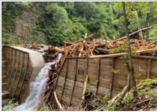
写真2 国土強靱化3か年緊急対策で整備した流木捕捉式治山ダムが令和2年7月豪雨で流木を捕捉（熊本県）
